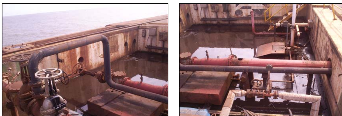
Figura 7 – Equipamentos de carga e descarga de óleo bastante deteriorado pelo tempo, ainda em operação no berço 201.
